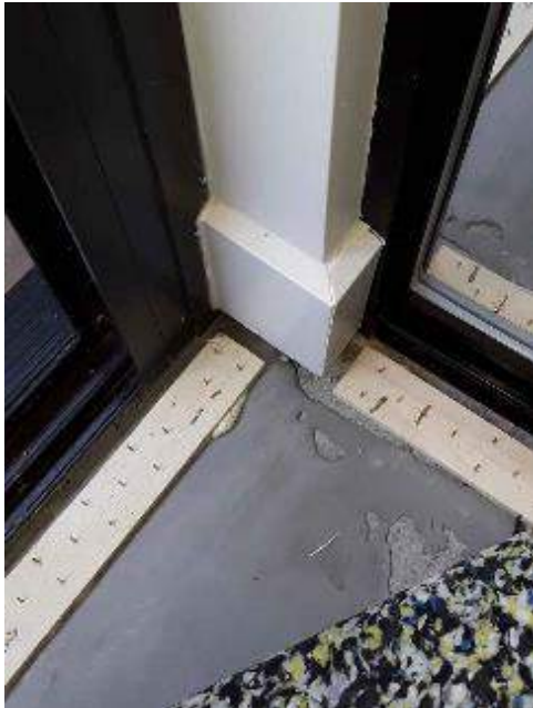
U 304.11 – Unit 304, bedroom 2 door threshold
